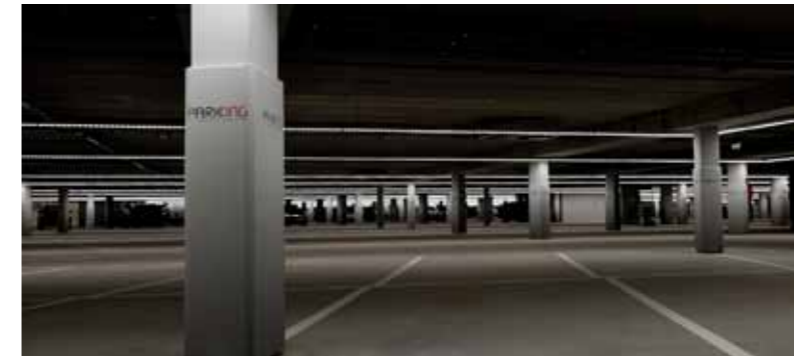
Energiesparende LED-Beleuchtung im Parkhaus
